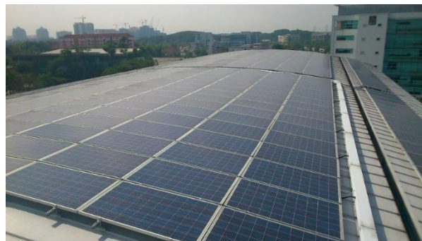
マレーシア・サイバージャヤでの導入
